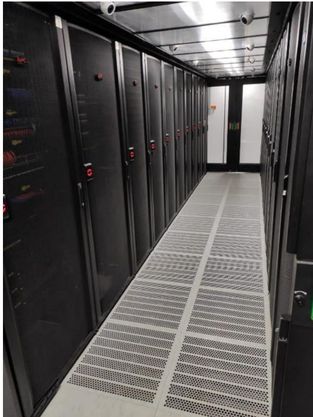
Система размещения оборудования в МЦОД
